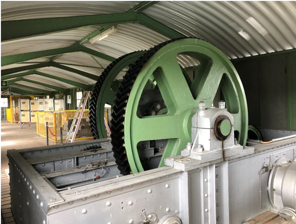
Kraftwerk Eglisau, Windwerkbrücke mit Wehrantrieb, (Vers. Nr. 01658), Dienststeg mit Wehrantrieb, Blick nach NW, 18.05.2019 (Bild Nr. D100567_09).
