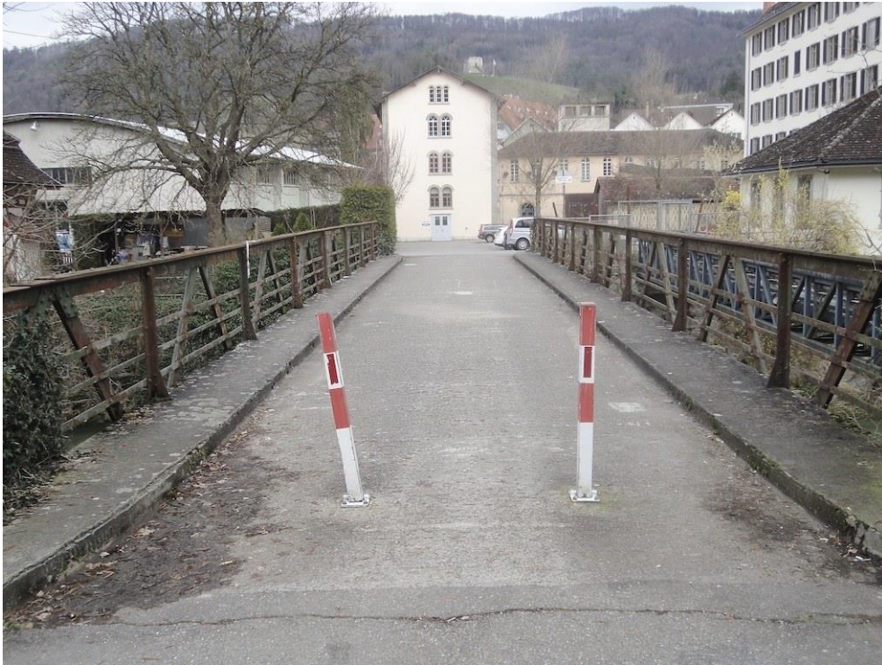
Ehem. Spinnerei Blumer, Fabrikanlage, Tössbrücke (057BRUECKE00001, 068BRUECKE00001), Blick über die Brücke nach N auf Vorwerk I (057VORWI00027), Ansicht von S, 12.03.2020 (Bild Nr. D100681_45).
