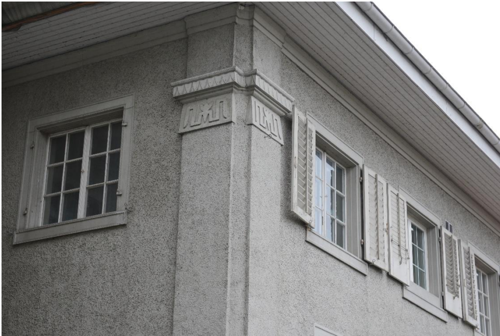
Schulhausensemble, Primarschulhaus (Vers. Nr. 00138), Eckpilaster mit reliefiertem Kapitell, Ansicht von N, 23.10.2014 (Bild Nr. D100600_20).
