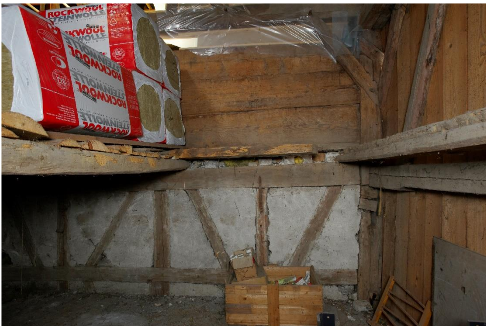
Ehem. Zehntenscheune, Hausteil NO (Vers. Nr. 01242), Abtrennung zwischen Wohn- und Ökonomieteil, eingebaut anlässlich der Umnutzung der Zehntenscheune im 19. Jh., Ansicht von SO, 27.11.2015 (Bild Nr. D100587_47).
