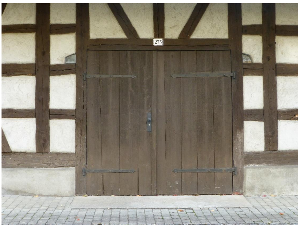
Ehem. Trotte, Tor an der Nordostfassade, Ansicht von NO, 24.10.2013 (Bild Nr. D100566_07).
