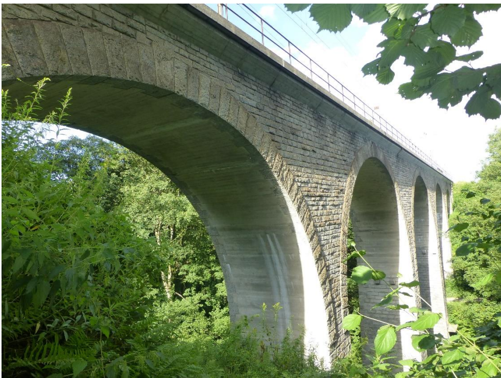
Bahnhof Embrach-Rorbas, Eisenbahnbrücke Wildbach (056BRUECKE00001, 068BRUECKE00003), Ansicht von SW, 30.07.2013 (Bild Nr. D100553_58).
