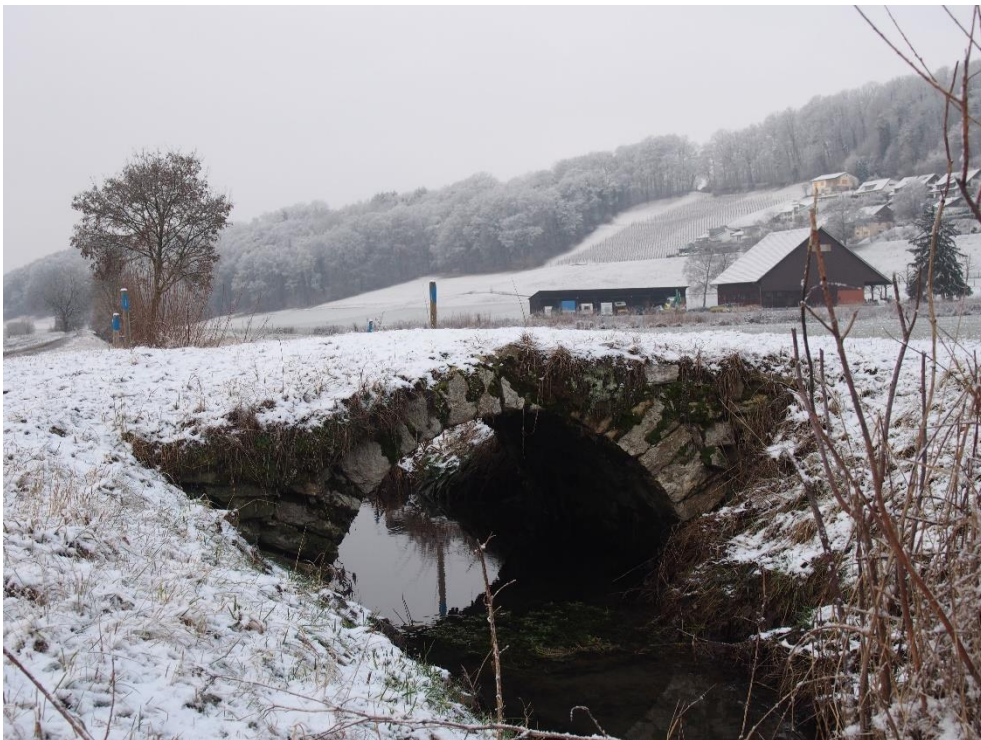
Brückenensemble am ehem. Kirchweg, Brücke Ost (061BRUECKE00002), Ansicht von O, 04.02.2019 (Bild Nr. D101096_78).
