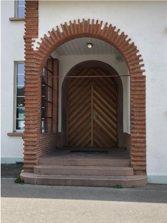
Ehem. Sekundarschulhaus mit Turnhalle, Haupteingang an der Westfassade, Ansicht von W, 17.05.2019 (Bild Nr. D101364_25).
