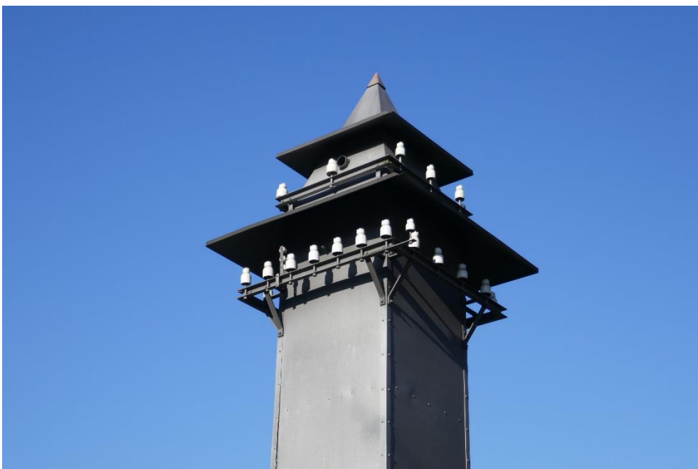
Transformatorstation «Bächli-Unterdorf, Teilansicht von SO, 06.12.2019 (Bild Nr. D100564_74).
