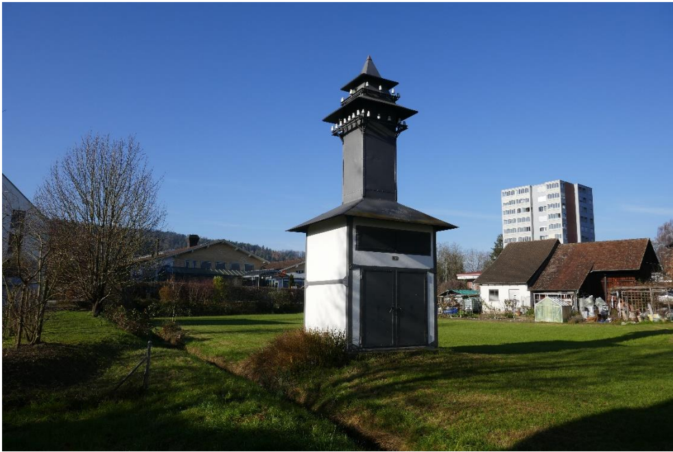
Transformatorstation «Bächli-Unterdorf, Ansicht von SO, 06.12.2019 (Bild Nr. D100564_75).
