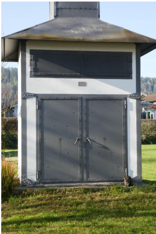
Transformatorstation «Bächli-Unterdorf, Teilansicht von O, 06.12.2019 (Bild Nr. D100564_73).
