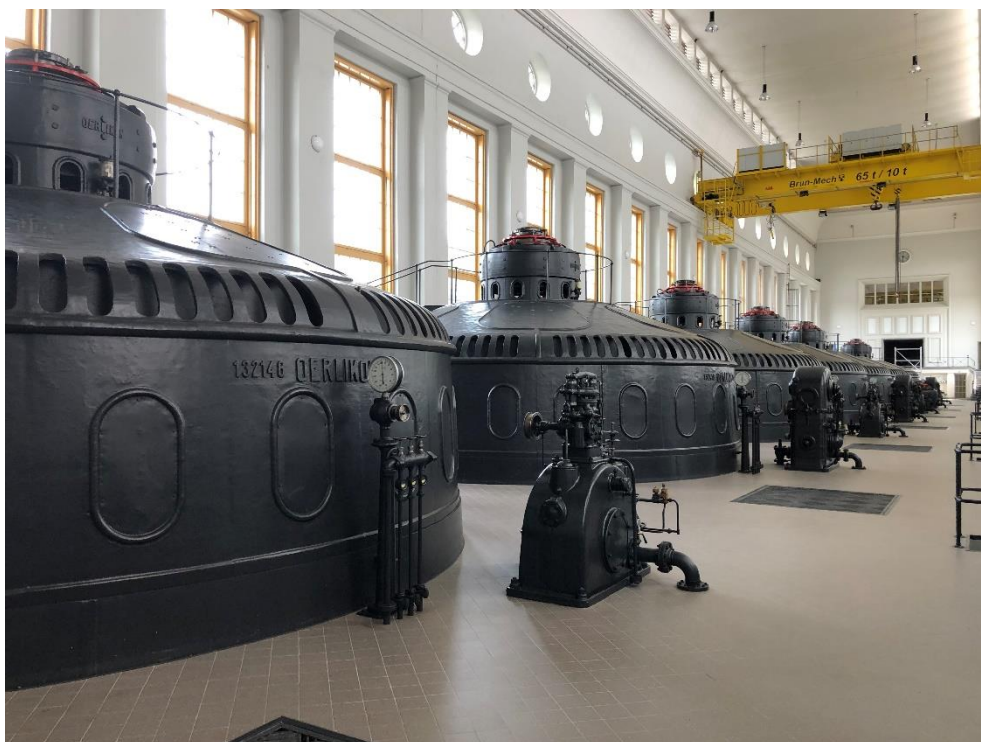
Kraftwerk Eglisau, Maschinenhaus (Vers. Nr. 01656), Maschinensaal mit Generatoren, Blick nach SO, 18.05.2019 (Bild Nr. D100567_15).
