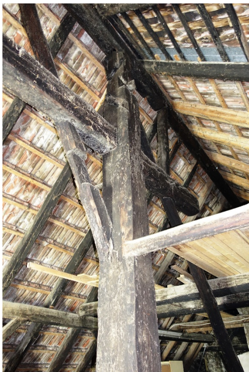
Ehem. Vielzweckbauernhaus, Wohnteil, Hochstud mit Windstrebe und gegen O verlängerter Firstpfette, Blick nach O, 16.11.2016 (Bild Nr. D100560_25).
