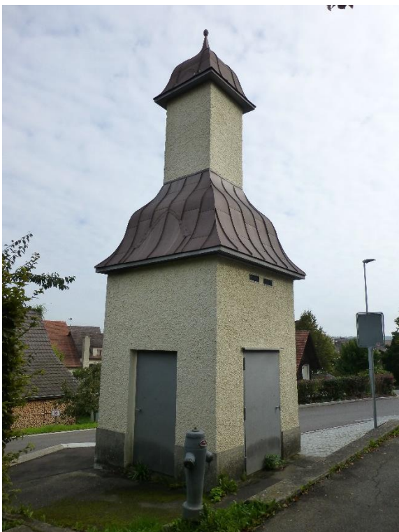
Transformatorstation «Dorf», Ansicht von SW, 26.09.2014 (Bild Nr. D100559_20).
