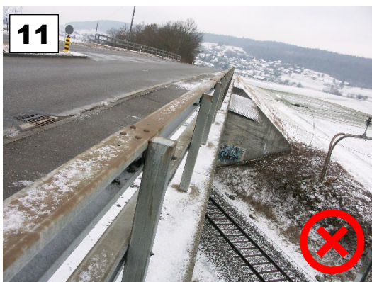
Unzulässig, u.a. wegen falscher (einbetonierter) Pfosten und fehlender Verstärkungen bei Kastenprofil
