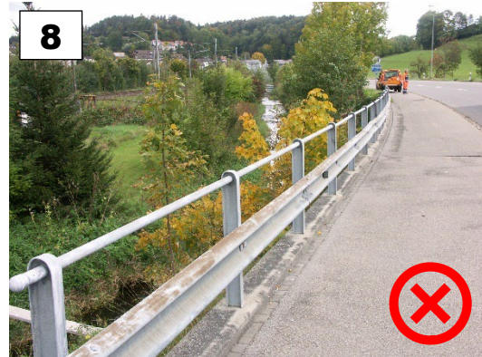
Unzulässig, u.a. wegen falscher Pfosten, Kombination mit Rohrgeländer
