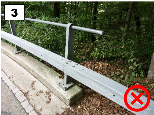
Unzulässig, weil falscher Pfostentyp, Kombination mit Rohrgeländer nicht zulässig
