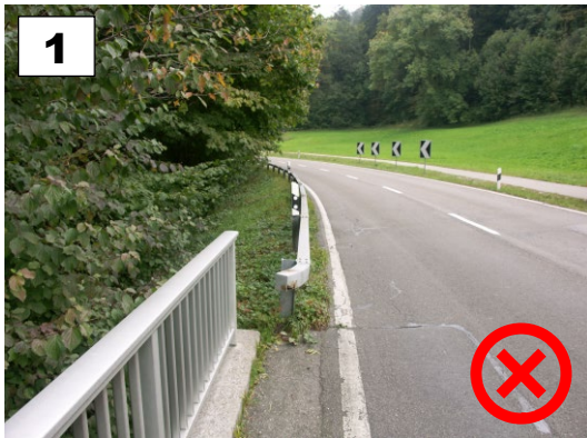
Unzulässig, u.a. weil LS vor Bauwerk stumpf endet
