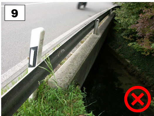
Unzulässig, u.a. wegen einbetonierter und fehlender Pfosten
