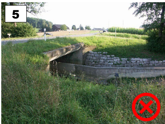
Fehlende Schutzeinrichtung / Geländer
