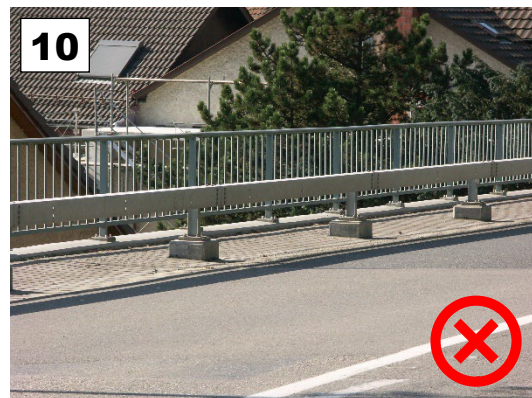
Unzulässige Systemgründung auf Betonfundamenten
