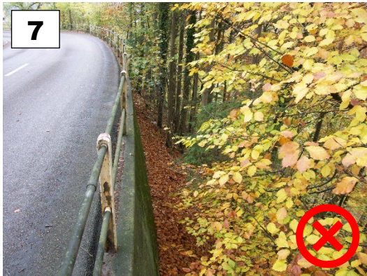
Unzulässig, u.a. wegen Geländerpfosten Notwendigkeit Fahrzeurückhaltesystem prüfen
