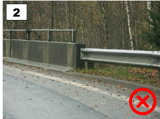
Unzulässig, weil LS nicht an Leitmauer kraftschlüssig angeschlossen
